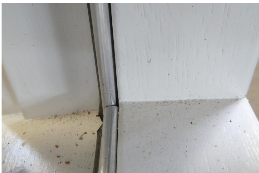
Foto 5 Dichtingsprofiel AIB 4G is gemonteerd met verzinktstalen nieten. Door deze veelgebruikte bevestigingswijze is het aluminium van het dichtingsprofiel vervormd en ontstaat een open naad tussen het profiel en het kozijn.
